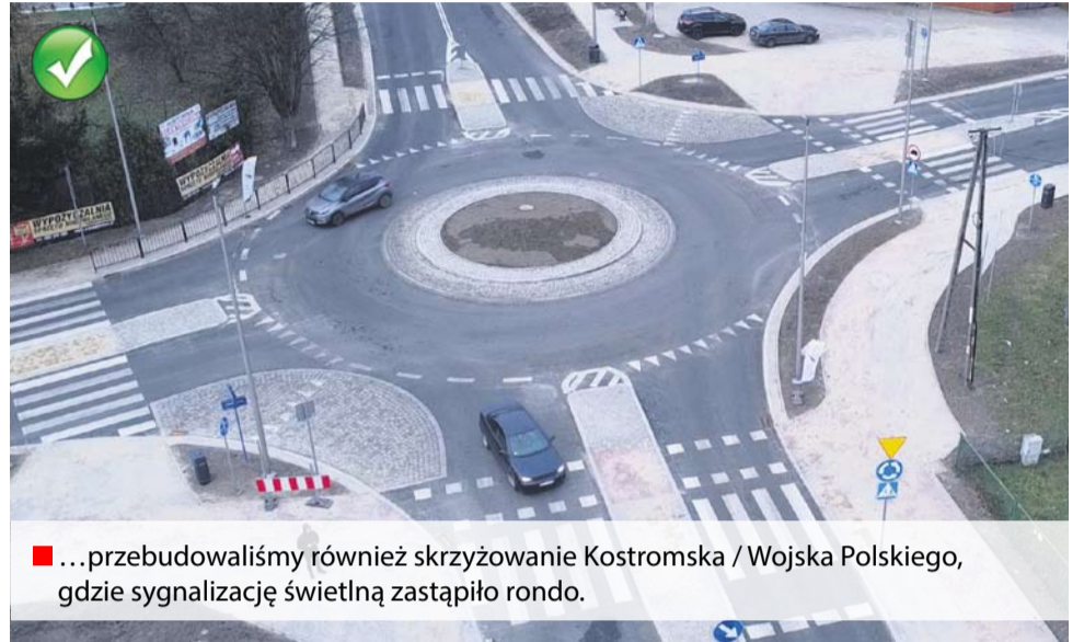
■ Na ulicy Wojska Polskiego (od ul. Kostromskiej do Al. Armii Krajowej) wykonaliśmy nie tylko przebudowę jezdni oraz chodników. Ale wybudowaliśmy nową magistralę wodociągową oraz ścieżkę rowerową, której tutaj nie było...
